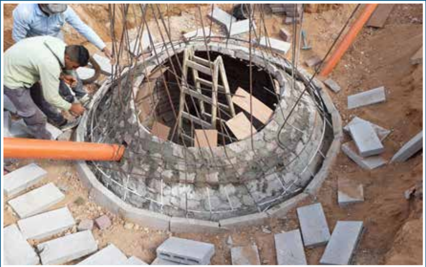
بناء جسم الهاضم بالطوب الحراري تثبيت مدخل المواد العضوية ومخرج المواد المهضومة
